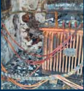
Havarisana oprema u trafostanici Sotonići
