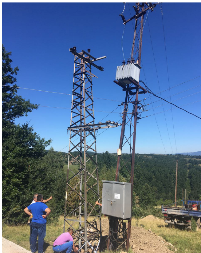
Novi stub za STS „Hoćevine“
