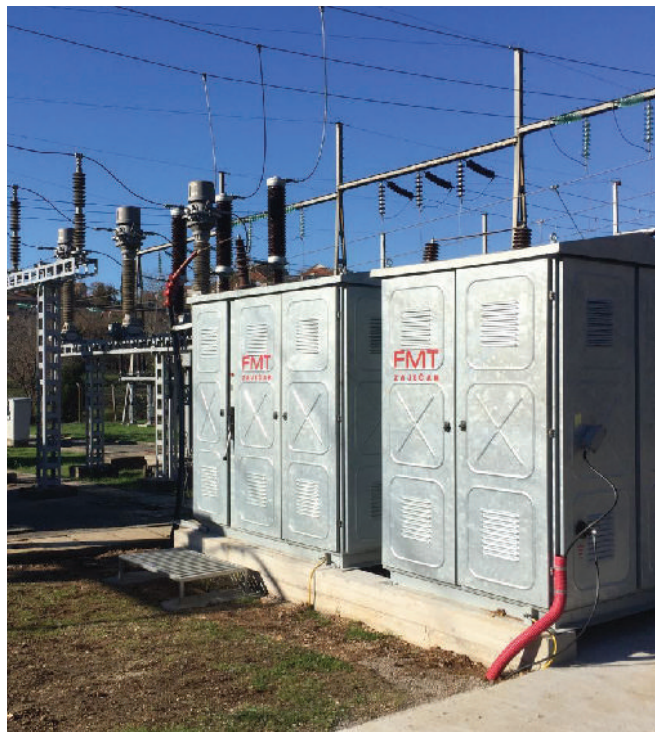
Otpornici za uzemljenje neutralne tačke na 35kV mreži u TS „Podi“
