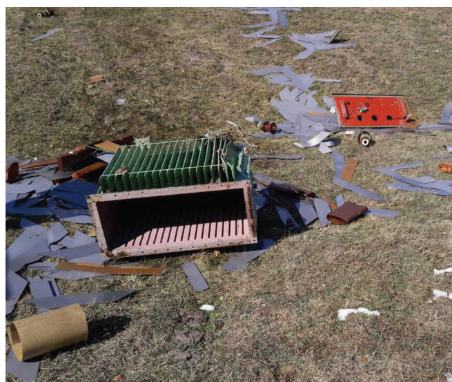
Havarisani transformator STS "Gradišnica"
