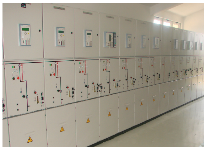
Postrojenje TS „Klinci“
