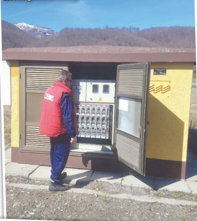
Novoizgrađena TS Lug
