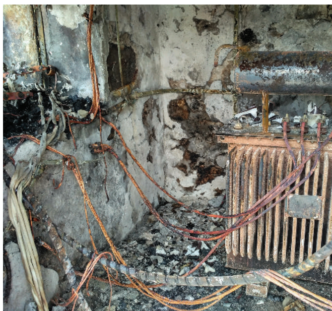
Havarisana oprema u TS Sotonići
