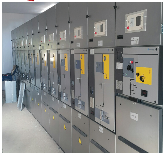
Postrojenje TS "Novi Ulcinj"
