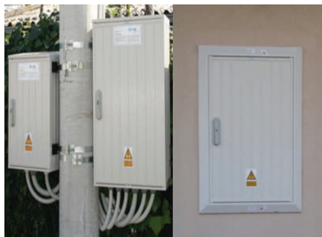
Rekonstruisani razvodni ormar
