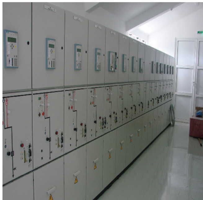
Nova oprema u TS "Klinci"
